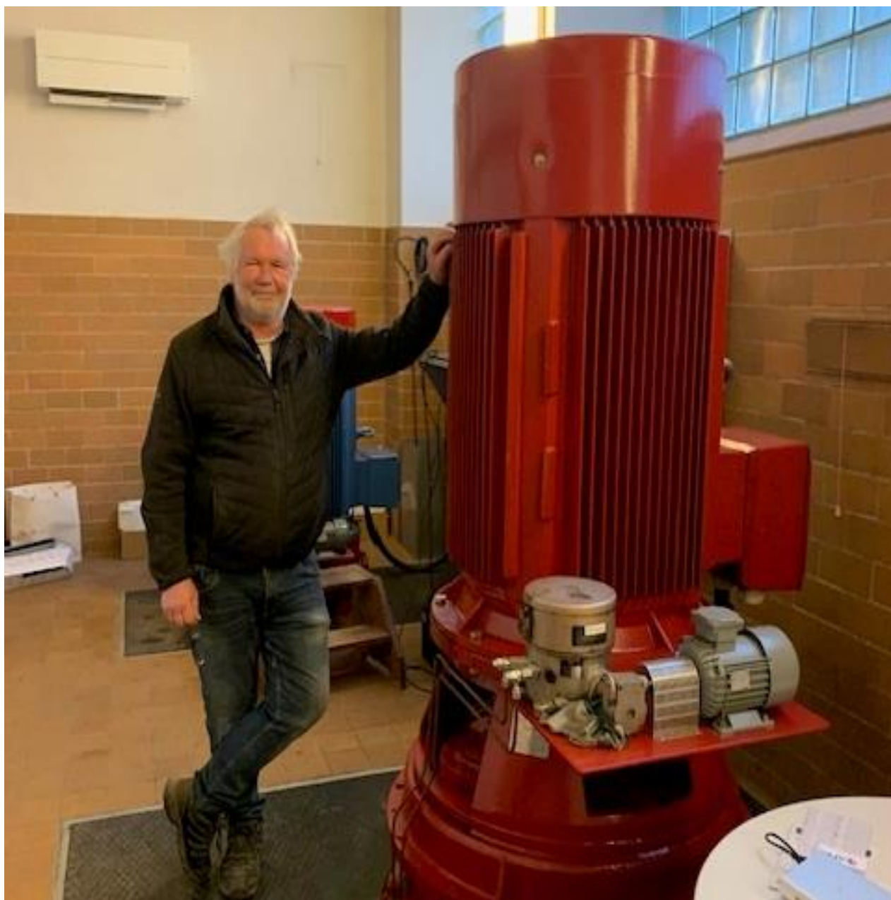
Pumpestationen i Marrebæk sørger for, at al vand i Marielyst pumpes ud i Guldborgsund. Her er pumpemester Torben Dynesen fotograferet ved en af de store pumper (Foto; Flemming J. Mikkelsen)
