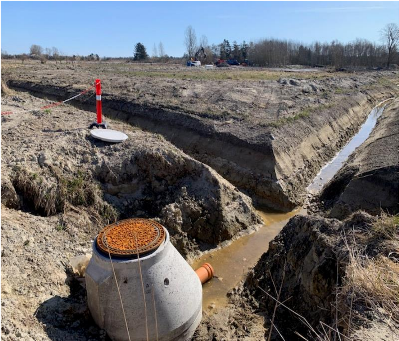
Oprensning af gamle grøfter eller kanaler - eller gravning af nye - er en af de løsninger, der arbejdes med for at få en bedre afvanding af Marielyst. Her et nyudstykket sommerhusområde ved Sildestrup Strand. (Foto: Flemming J. Mikkelsen)
